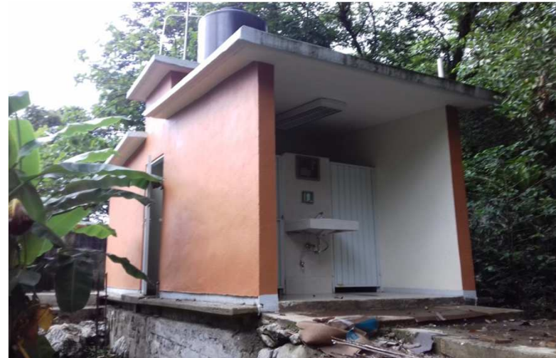
EP BENITO JUAREZ BARRIO DE LAS GOLONDRINAS, AQUISMON, S.L.P. MEJORA DE LA INFRAESTRUCTURA FISICA EDUCATIVA DEL PLANTEL
