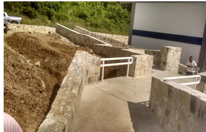
INTERCULTURAL DE SAN LUIS POTOSI, UNIDAD ACADEMICA DE TANCANHUITZ, BARRIO CHACANA, TANCANHUITZ, S.L.P. RAMPA ENTRE EDIFICIOS
