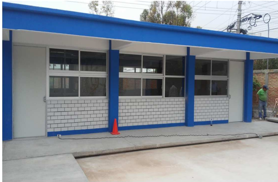
CECyTE II REAL DE MINAS, SAN LUIS POTOSI, S.L.P. CONSTRUCCION DE UN AULA DIDACTICA DE 3 ENTRE EJES ESTRUCTURA U-1C Y OBRAS EXTERIORES
