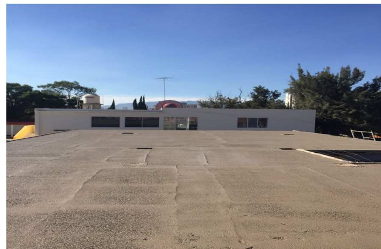
BENEMERITA Y CENTENARIA ESCUELA NORMAL DEL ESTADO, SAN LUIS POTOSI, S.L.P. 3A. ETAPA DE CONSTRUCCION DE LA UNIDAD EDUCATIVA SIGLO XXI, ESTRUCTURA PRIMER NIVEL
